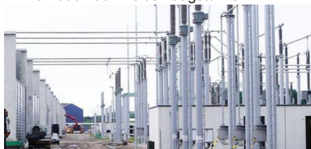
"Uitbreiden in energienetwerken" Transformatiestation, Wijk aan Zee
