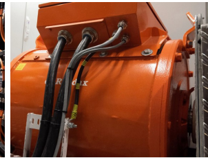
Machinekamer met electromotoren
